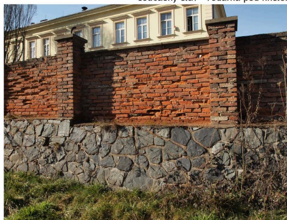
současný stav - rozpadající se obvodová zeď parku
