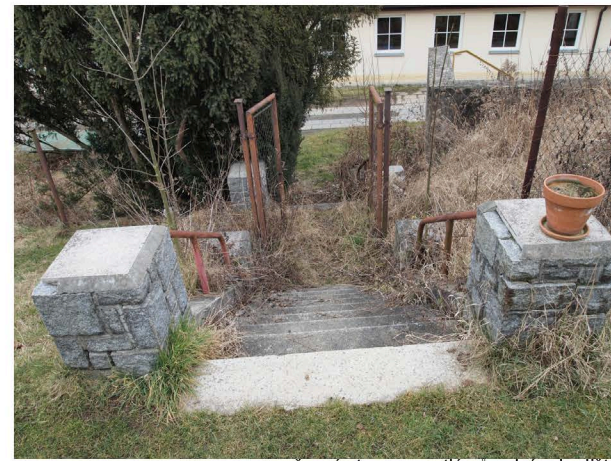
současný stav - zarostlé původní schodiště
