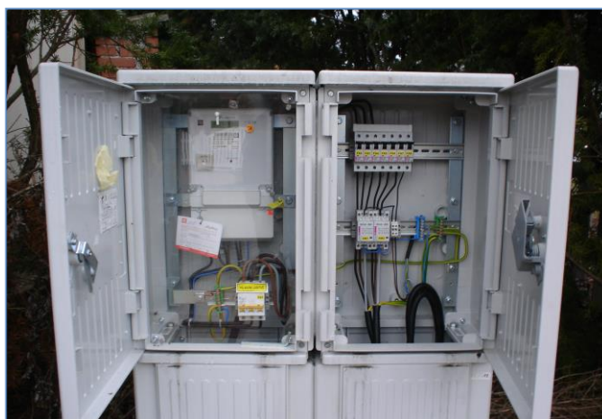
Obrázek 8 – Ukázka rozvaděče veřejného osvětlení
